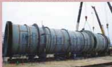
▼ Astoria - HRSG Stack
